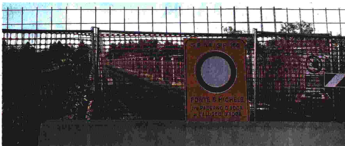
Manutenzioni e monitoraggi sotto accusa. Ponte San Michele, che collega le province di Lecco e Bergamo, chiuso dopo la verifica del 14 settembre: non c'erano i requisiti di sicurezza
